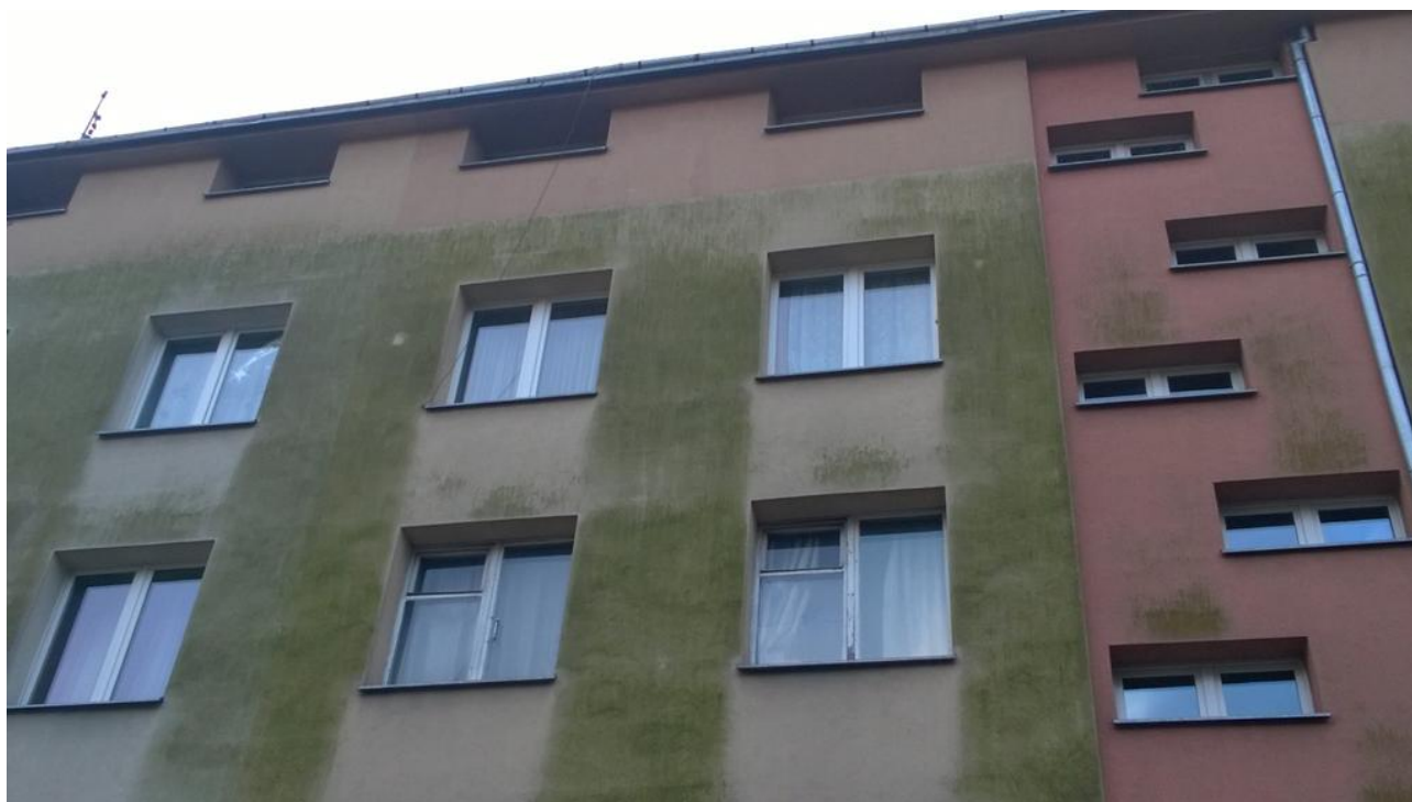
Fot. 1. Bardzo duży rozwój infekcji mikrobiologicznej na powierzchni ściany gdzie zastosowano tynk ze zbyt małą ochroną przed powstawaniem glonów.
